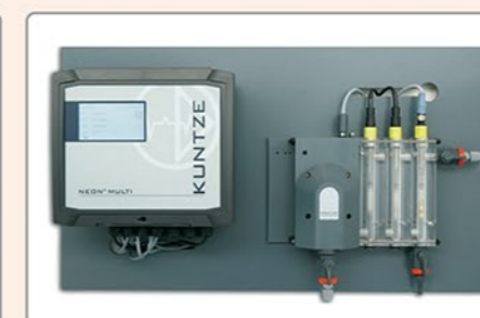
Klormätning, Fritt, Total
